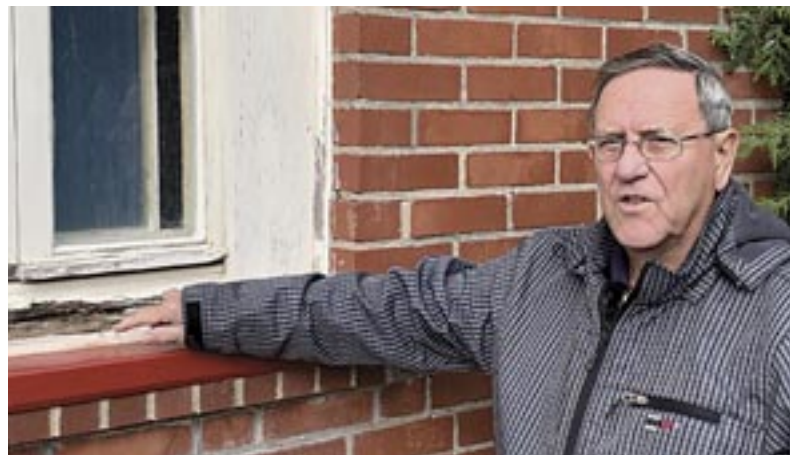
Gilles Ducharme indique la détérioration des fenêtres.
